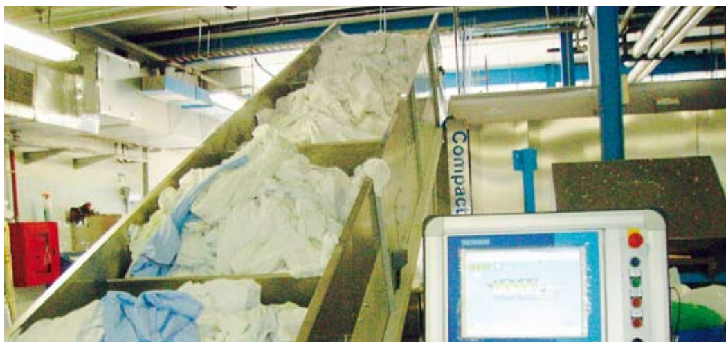
Nuevo túnel de lavado
